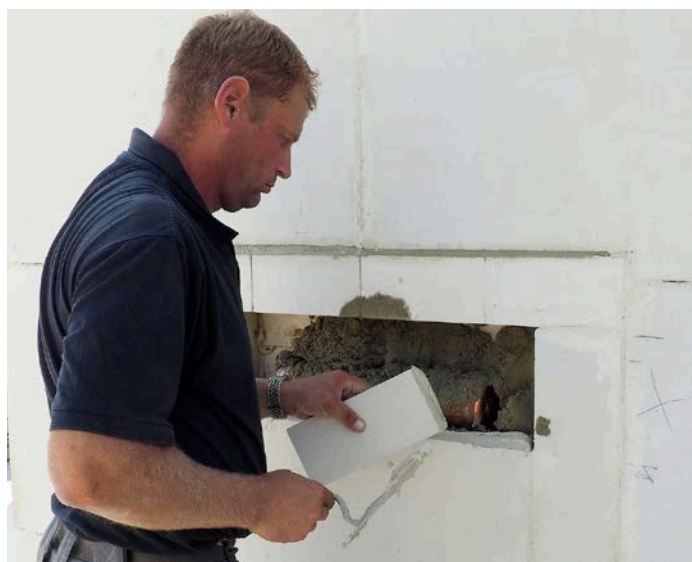
Polier Sergej Braun von der Firma Hartmann Bau mauert die Zeitkapsel in eine Innenwand der Kita.
